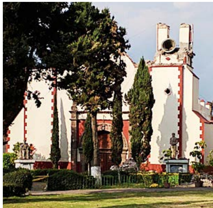
Figura 13. Colapso del campanario en la capilla del poblado de Santa Cruz Acalpíxca. Foto: F. Chiapa.
