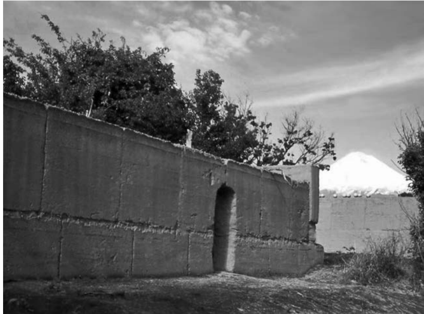
FIGURA 2 Casa rural en Ozolco, Puebla, 1967: muros de barro apisonado entre moldes de madera, con refuerzo de varas. Foto: AGP.
